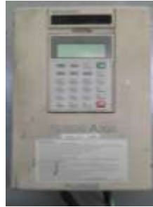
Figura 4.8.- Variador de frecuencia.
